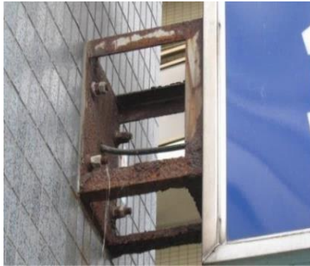
接合部(ブラケットの腐食劣化)
