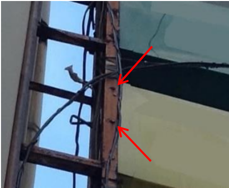
取付部(ボルトのゆるみや欠落)
